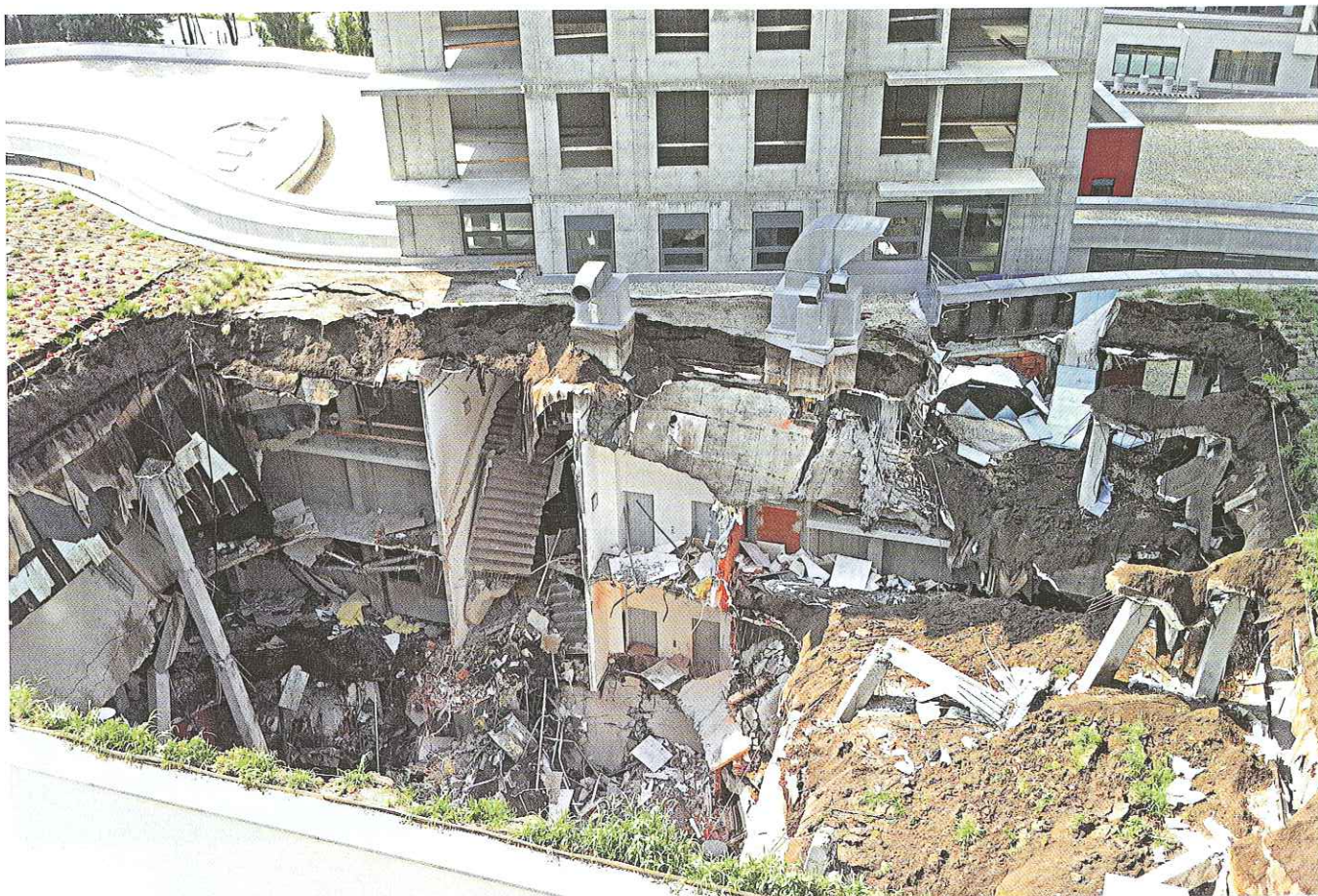
Spadnutá garáž v komplexe Trinity len odhalila vrchol problému nekvalitných realizácií stavieb.
